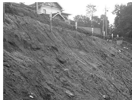
写真-1 被災状況
